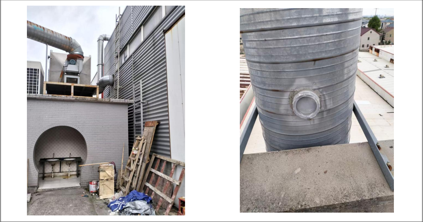
图 4-1 现场活性炭吸附装置及出口检测口照片
