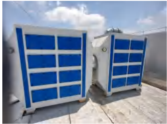
废气处理装置
