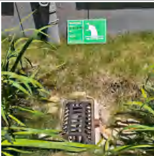
雨水排口环保标识牌
