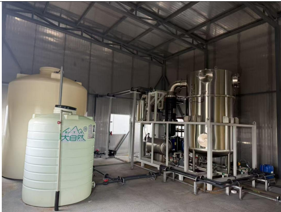
污水处理设施
