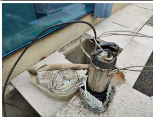
应急泵及水管
