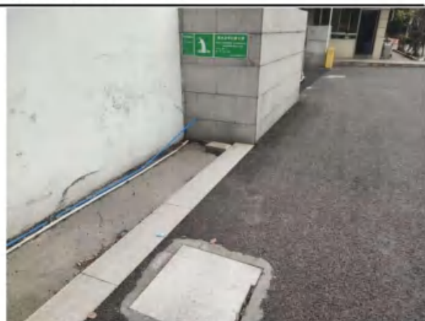
雨水总排口截止阀门标识牌
