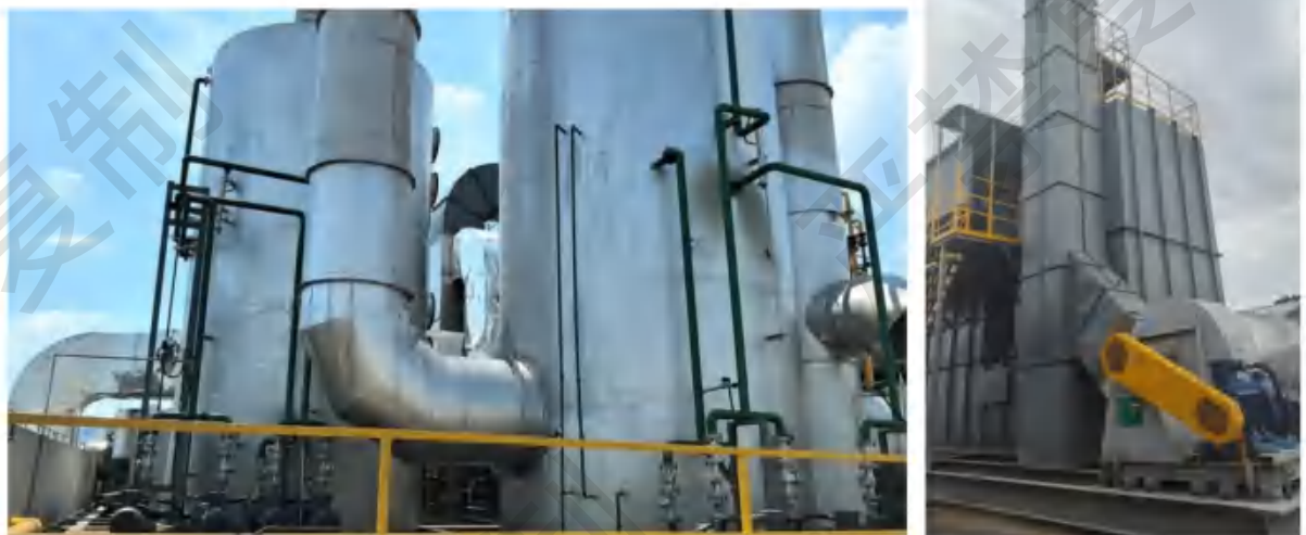
图3-1 2套DMF吸收塔+干式过滤+RTO+DA001排气筒
