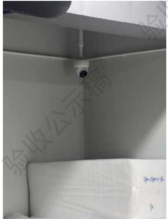
危险废物贮存设施外部监控
