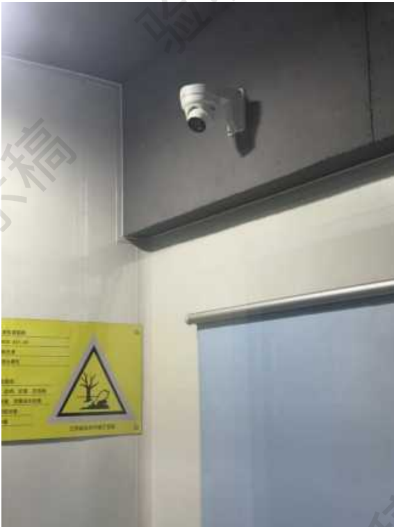
危险废物贮存设施内部监控
