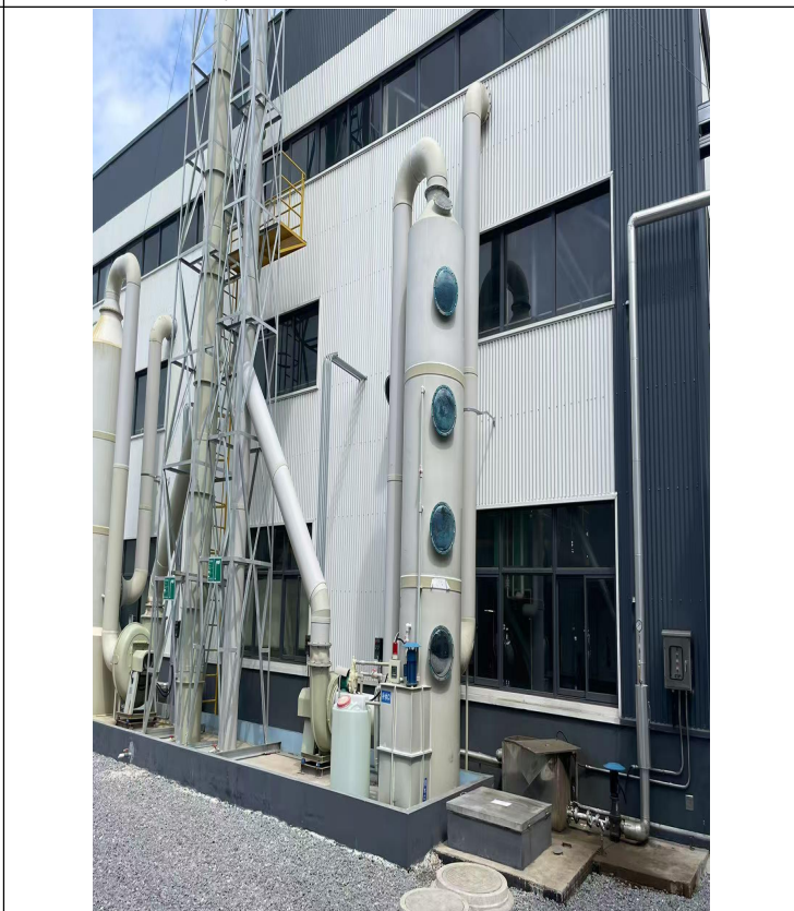
FQ-02 处理设施 (三级酸洗塔)
