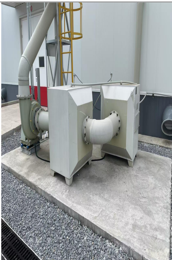
FQ-08 处理设施 (二级活性炭)
