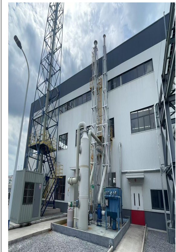
FQ-04 排气筒 15 米 (DA002)
