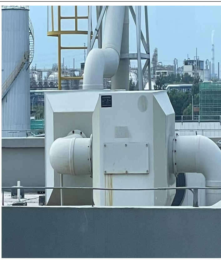
FQ-09 处理设施 (二级活性炭)
