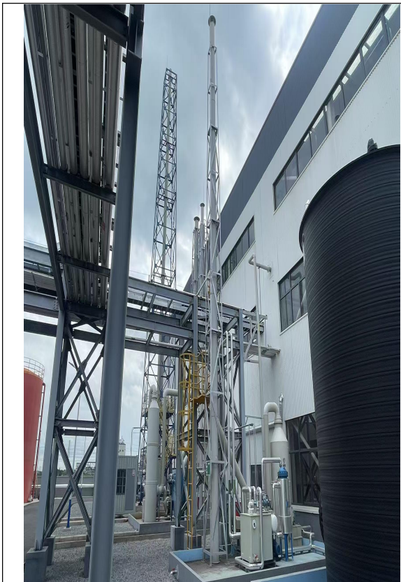
FQ-05 排气筒 15 米 (DA003)
