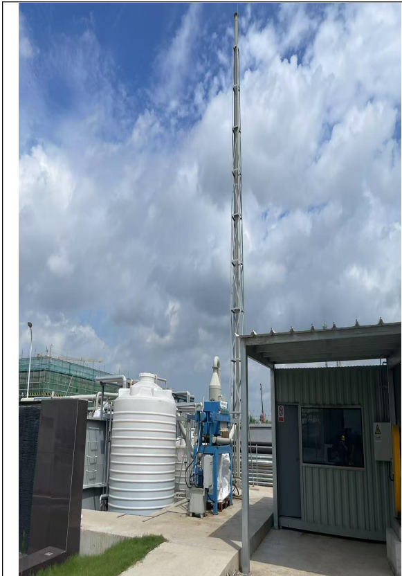
FQ-11 排气筒 15 米 (DA009)
