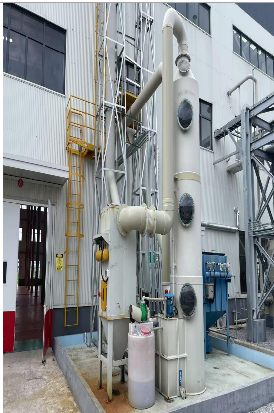
FQ-07 处理设施 (碱喷淋+布袋除尘)
