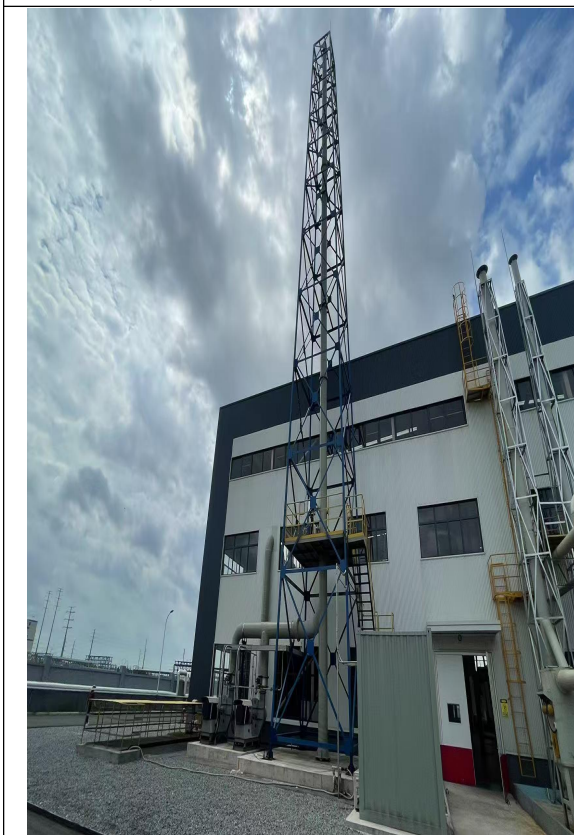
FQ-06 排气筒 35 米 (DA004)
