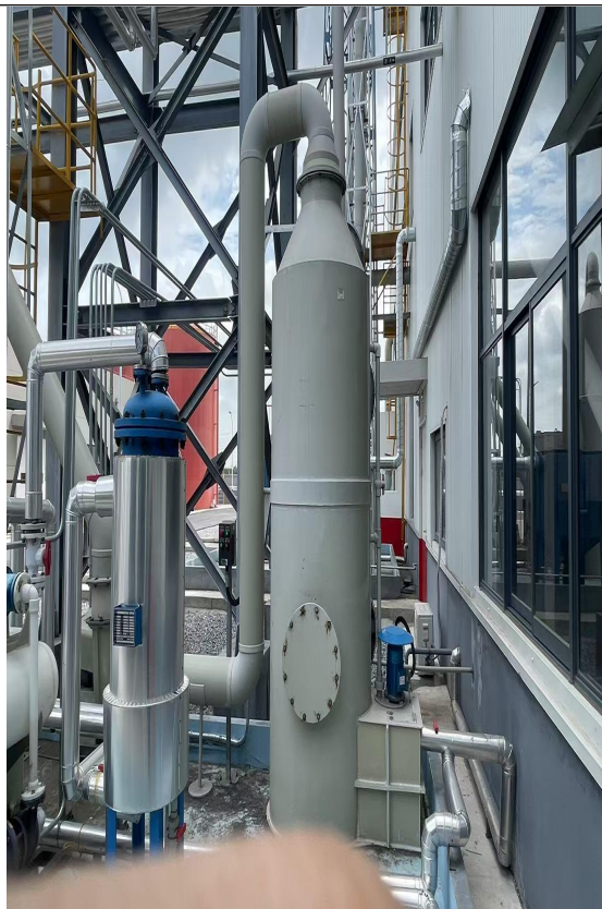
FQ-05 处理设施 (三级水洗塔)
