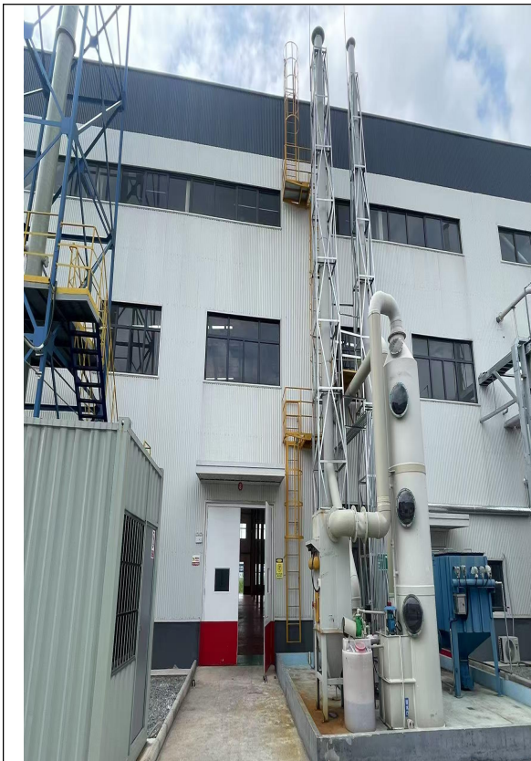
FQ-07 排气筒 15 米 (DA005)
