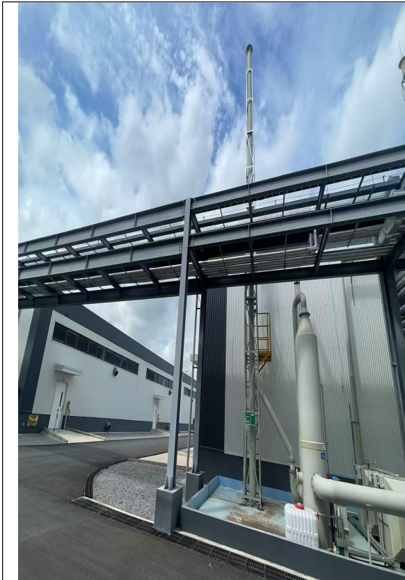
FQ-03 排气筒 15 米 (DA001)
