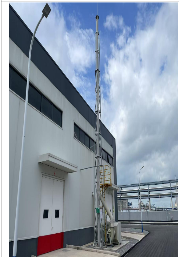
FQ-08 排气筒 15 米 (DA010)
