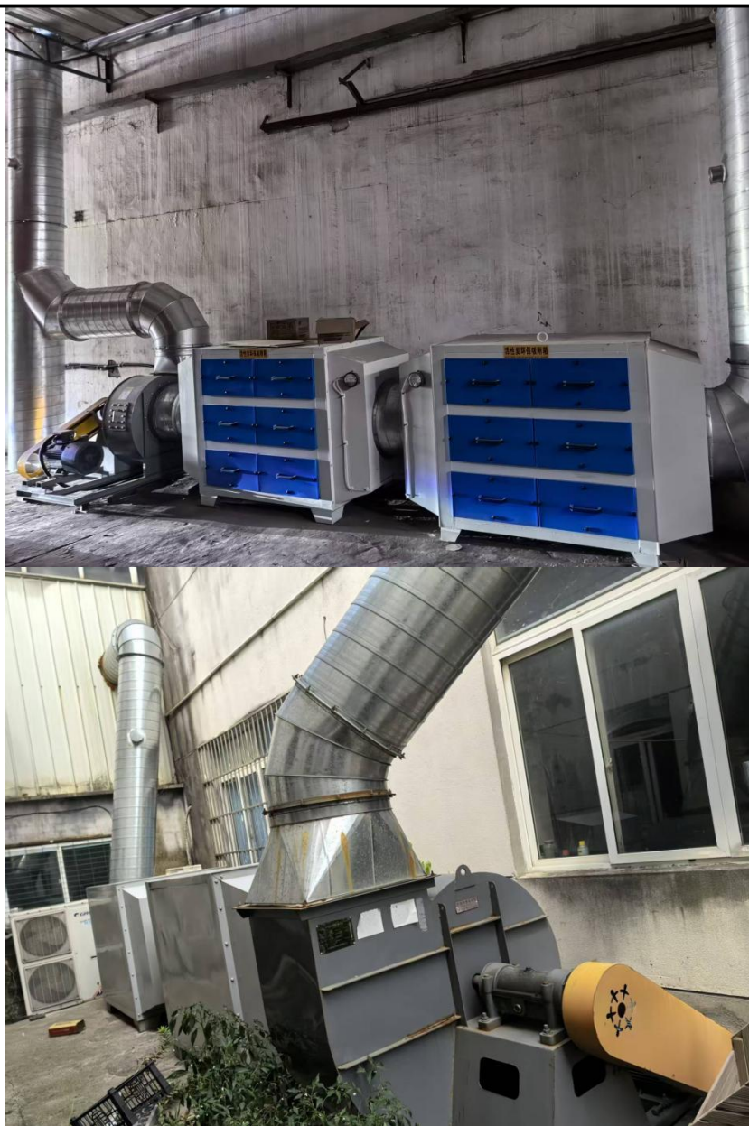
图 3-1 现场两级活性炭装置及排气筒照片
