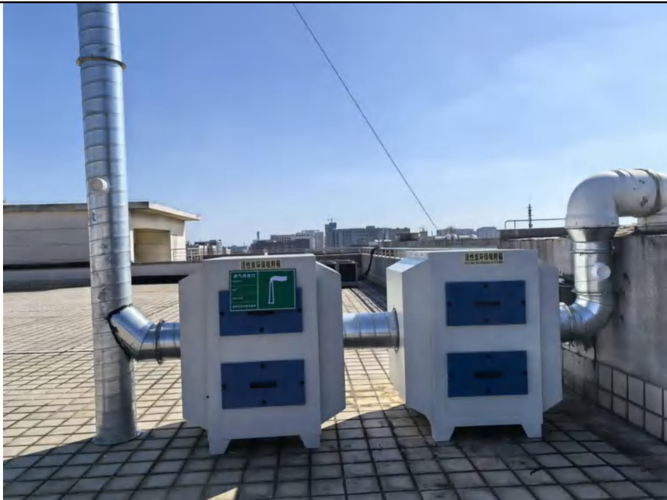
图 3-1 现场两级活性炭装置及排气筒照片
