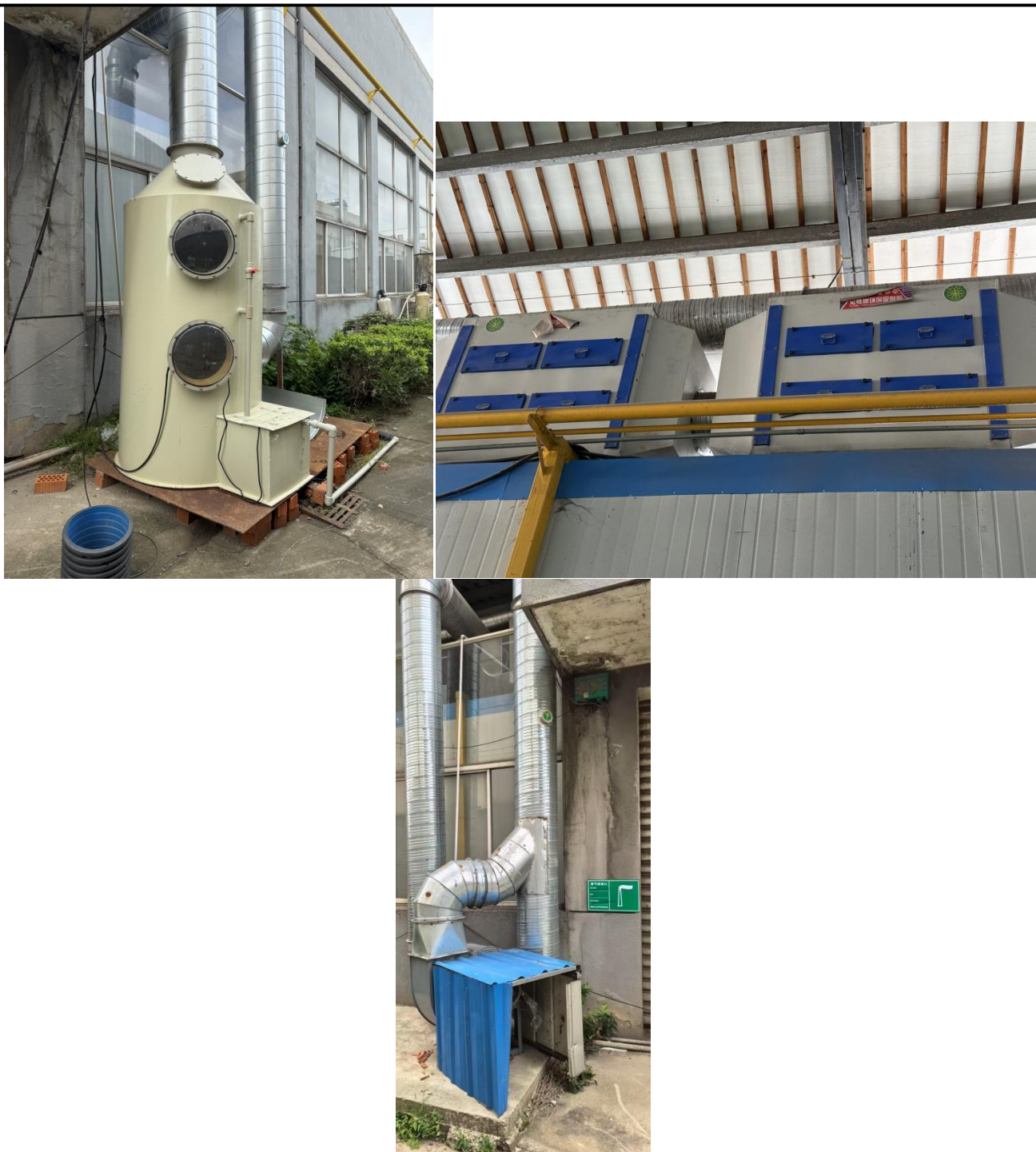
图 3-1 现场脉冲布袋除尘器、水喷淋+纤维过滤棉+二级活性炭吸附装置及排气筒照片
