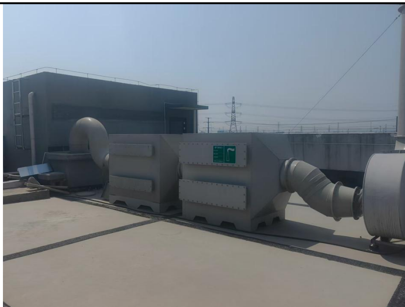
图 3-1 现场两级活性炭装置及排气筒照片
