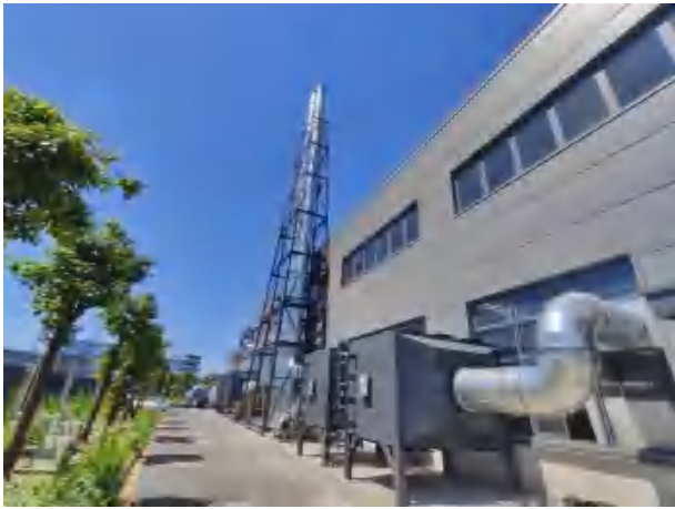
TA005 二级活性炭吸附处理装置（修补、设备清洗废气）
