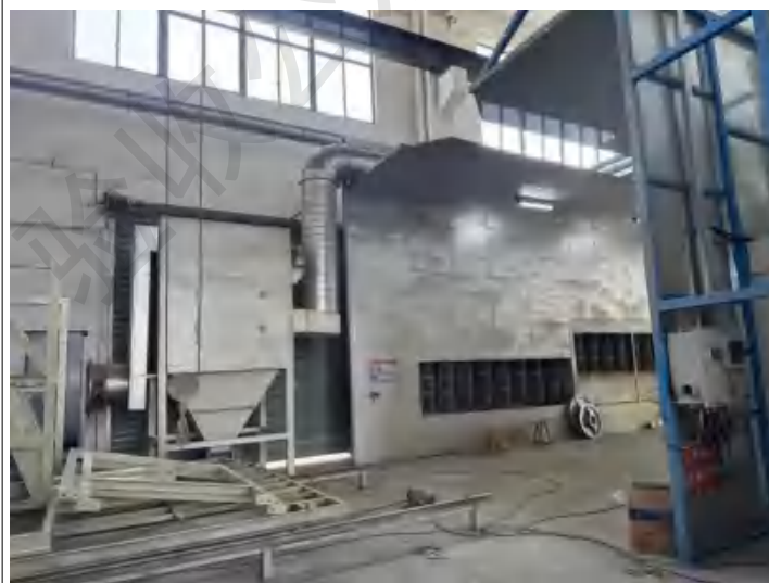
喷粉废气经侧吸罩收集 (脉冲除尘+滤芯除尘处理后无组织排放)
