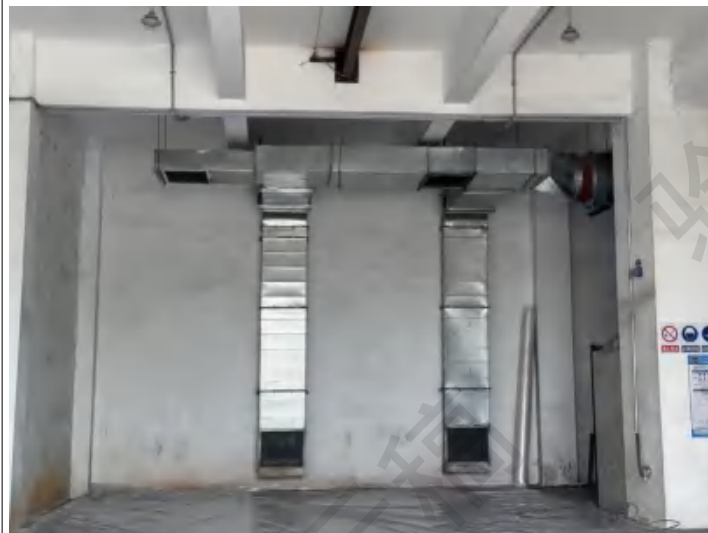
调漆、喷漆、晾干废气经喷漆房密闭负压收集
