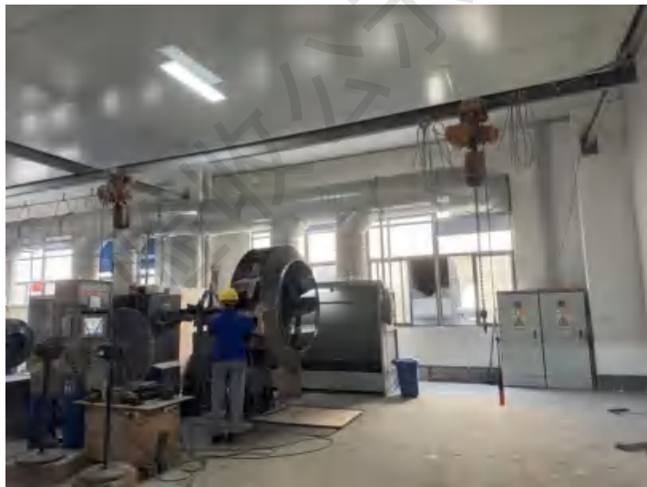
风机叶轮打磨废气经集气罩收集 (水帘机处理后无组织排放)
