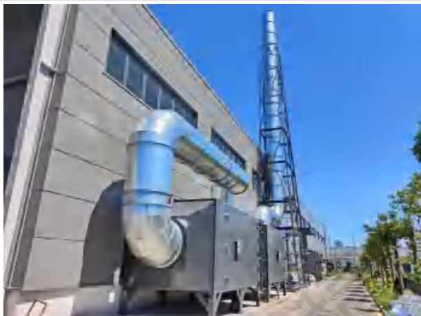
TA004 过滤棉+二级活性炭吸附处理装置(调漆、喷漆、晾干废气)
