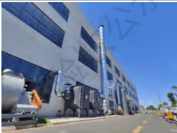
TA001 水帘+水喷淋塔(切割、封边废气)
