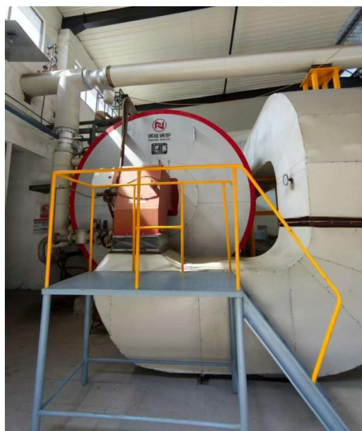
12000KW 天然气有机热载体炉
