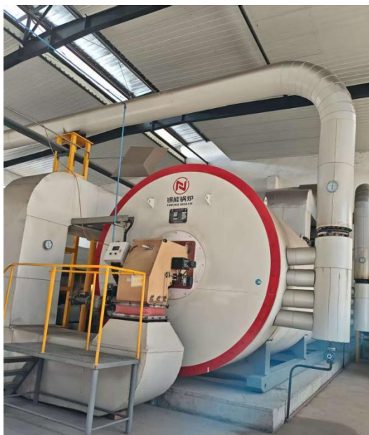
6000KW 天然气有机热载体炉
