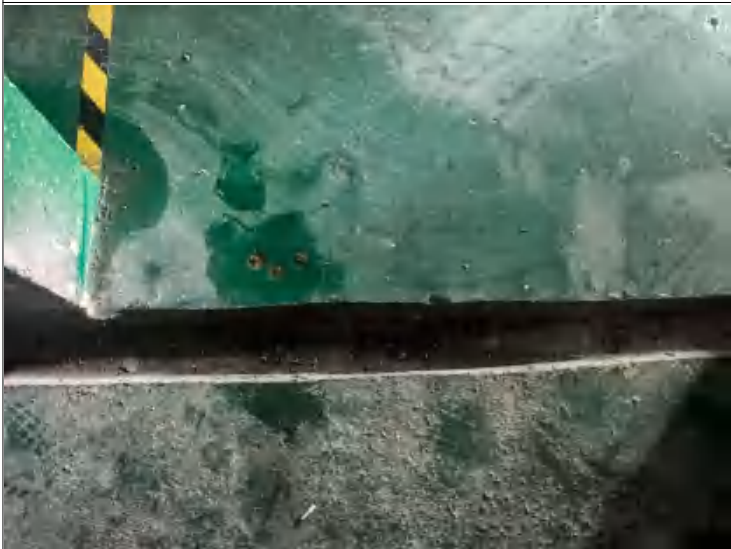
危险废物仓库
