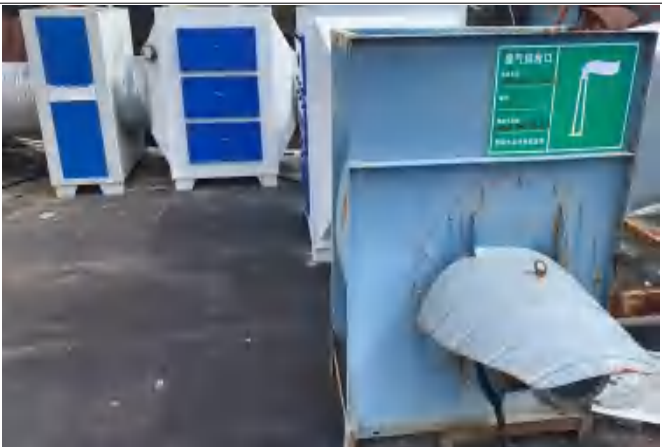
废气排放口环保标识牌
