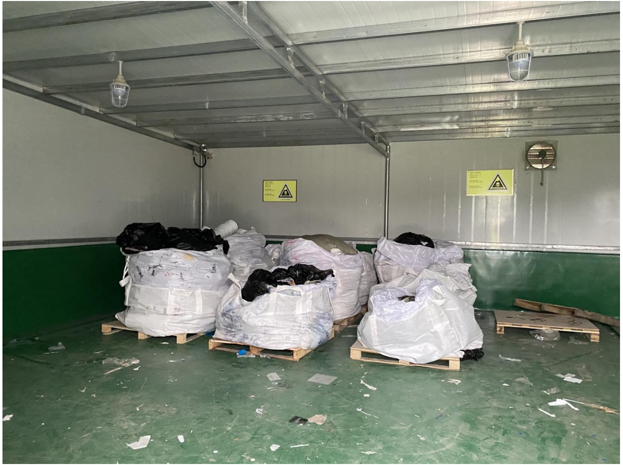
附图 8 危险废物暂存仓库（内部）
