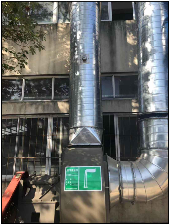
1#排气筒（DA001）及其处置现状情况
