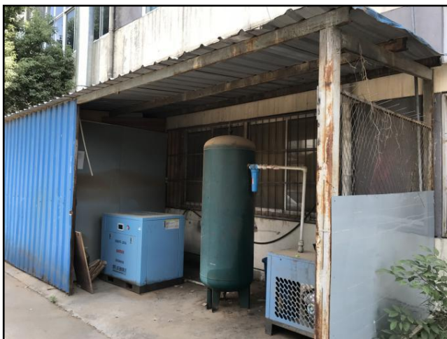
高噪声设备空压机隔声措施及位置现状
