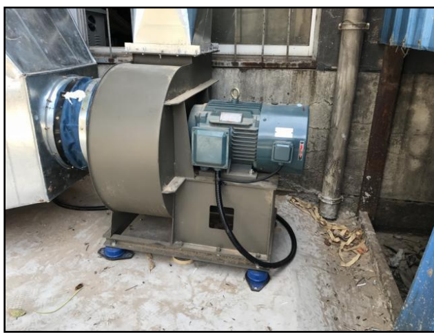
风机减震措施
