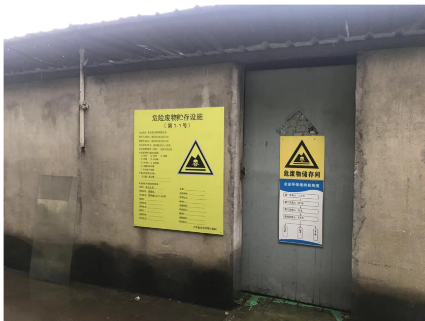
危废暂存间环保标识
