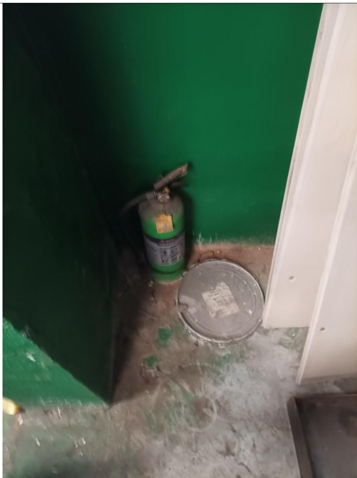
图 3-5 危废仓库消防
