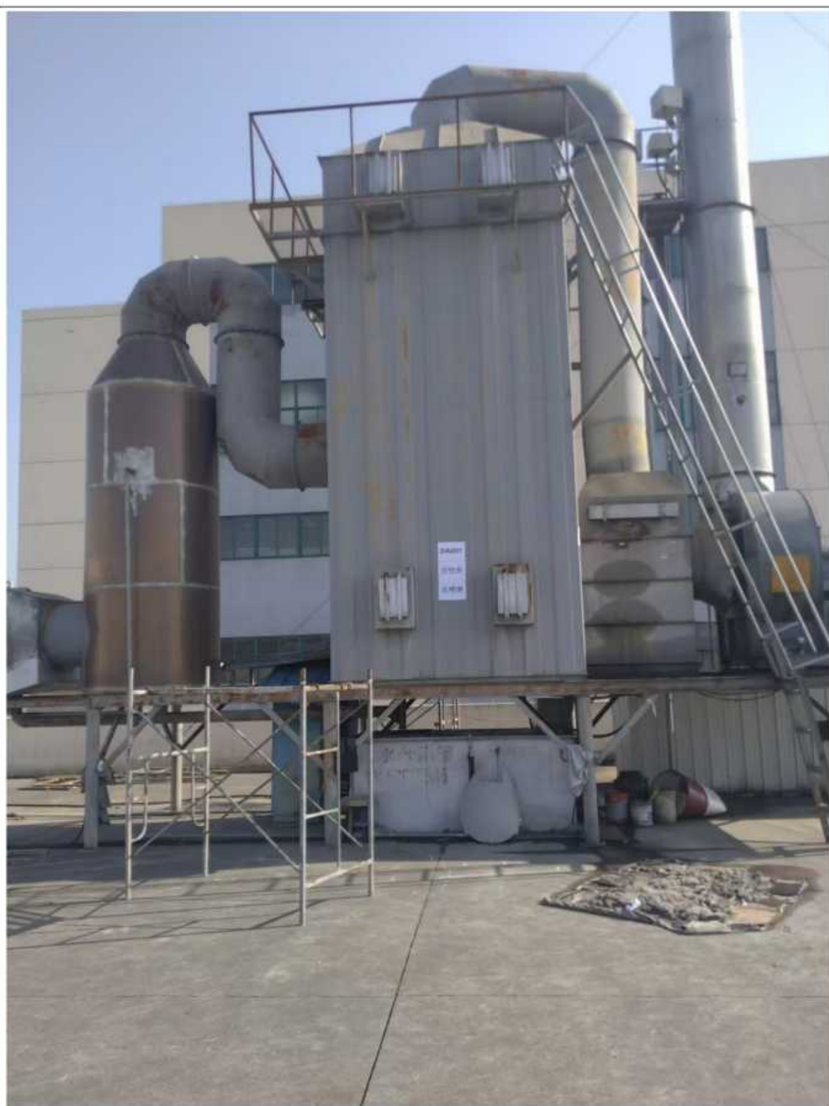
图 3-1 企业造粒废气处理设施 1 及配套排气筒（喷淋水洗+活性炭吸附装置）
