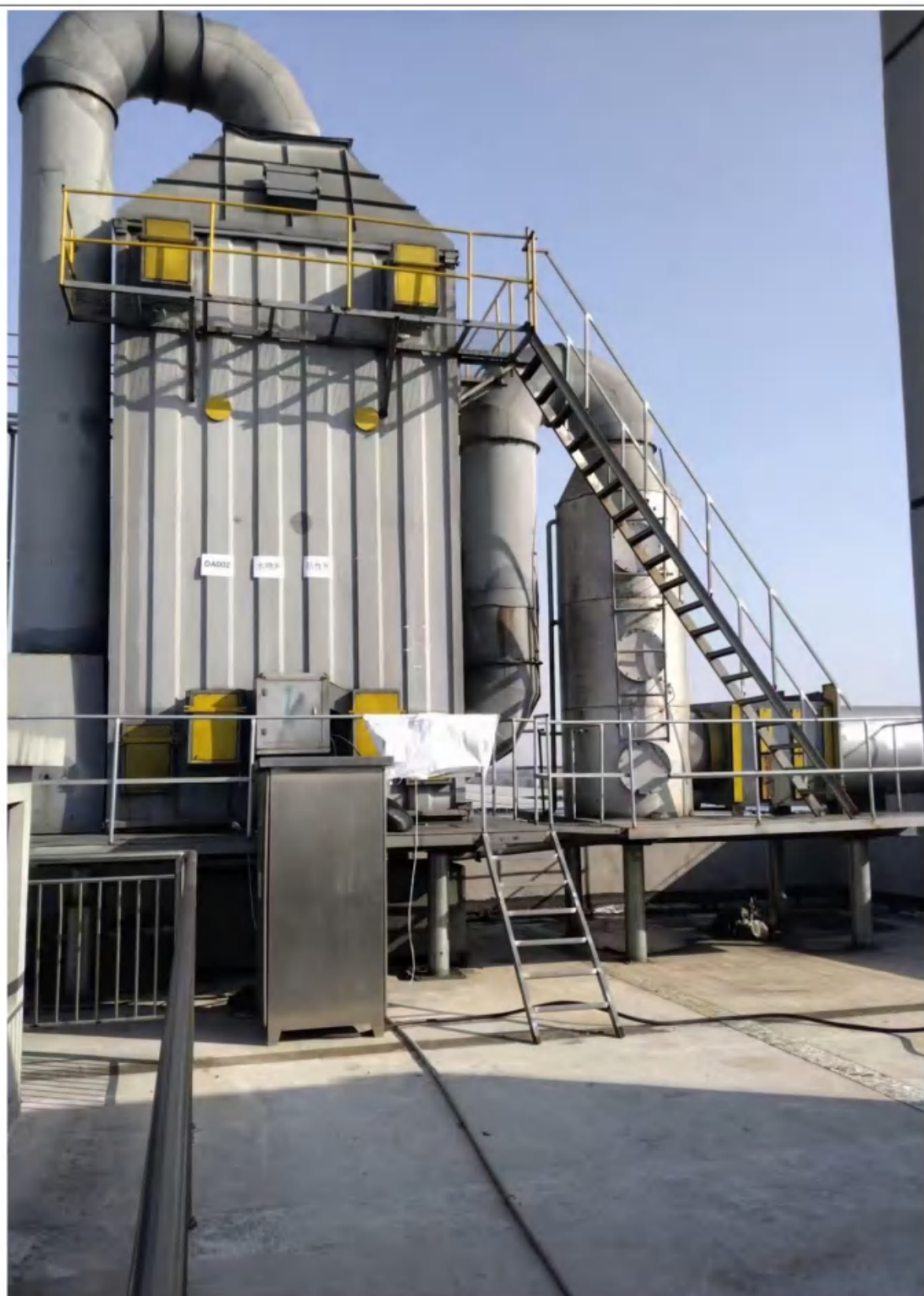
图 3-2 企业造粒废气处理设施 2 及配套排气筒（喷淋水洗+活性炭吸附装置）
