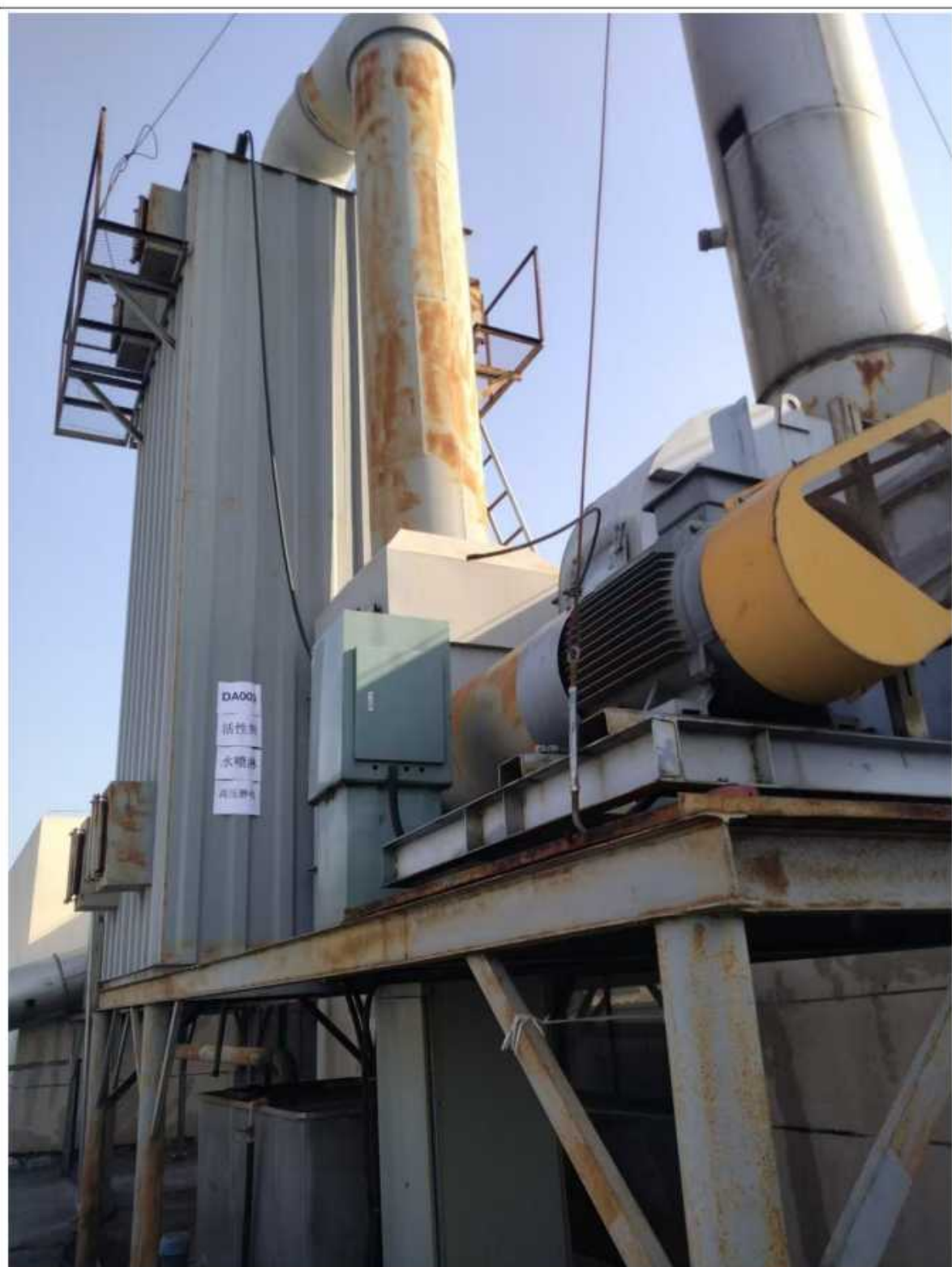
图 3-3 企业螺杆挤出废气、纺丝油剂废气处理设施及配套排气筒（高压静电+水喷淋+活性炭吸附装置）
