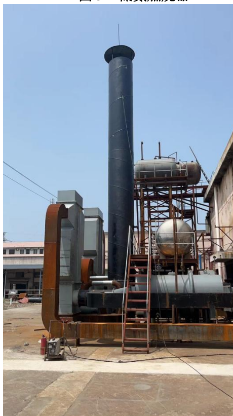
图 3-2 现场排气筒照片
