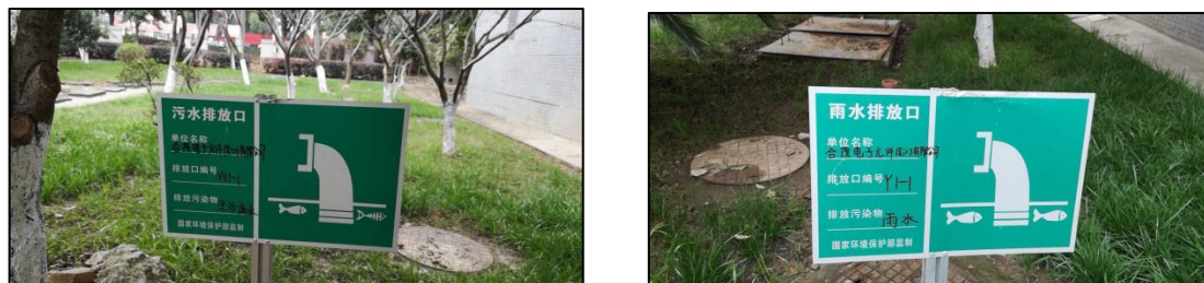
图 4 -2 废水排放口环保标志牌
