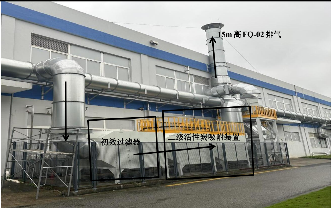
图 3-8 废气处理设施（FQ-02 排气筒）
