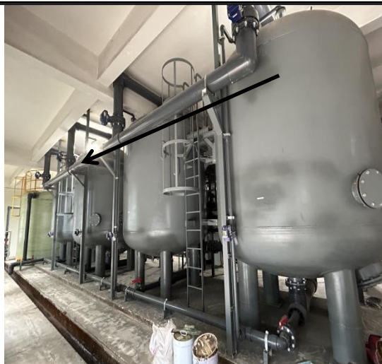
多介质过滤罐+活性炭过滤器+过滤水箱
