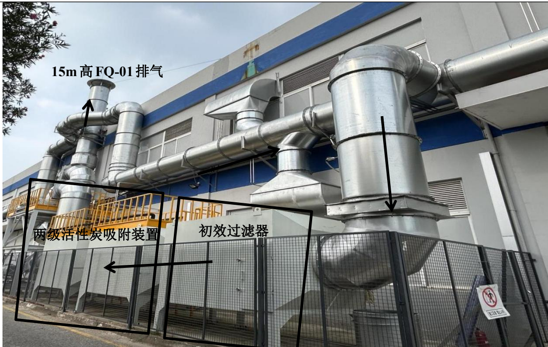
图 3-7 废气处理设施（FQ-01 排气筒）
