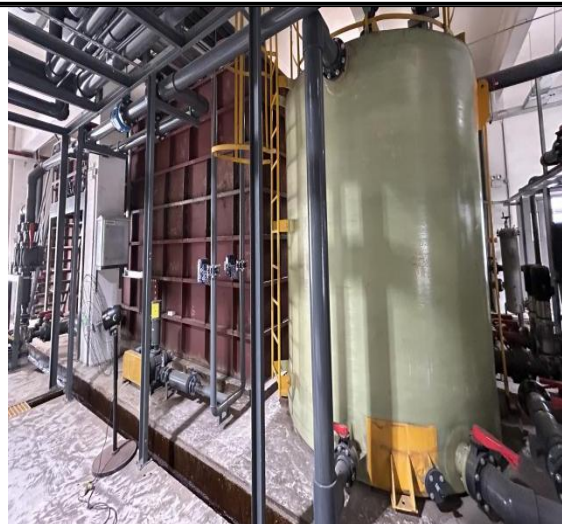
调节水箱（原水池）
