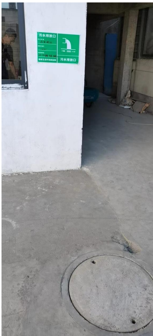
图 4-2 生活污水排口
