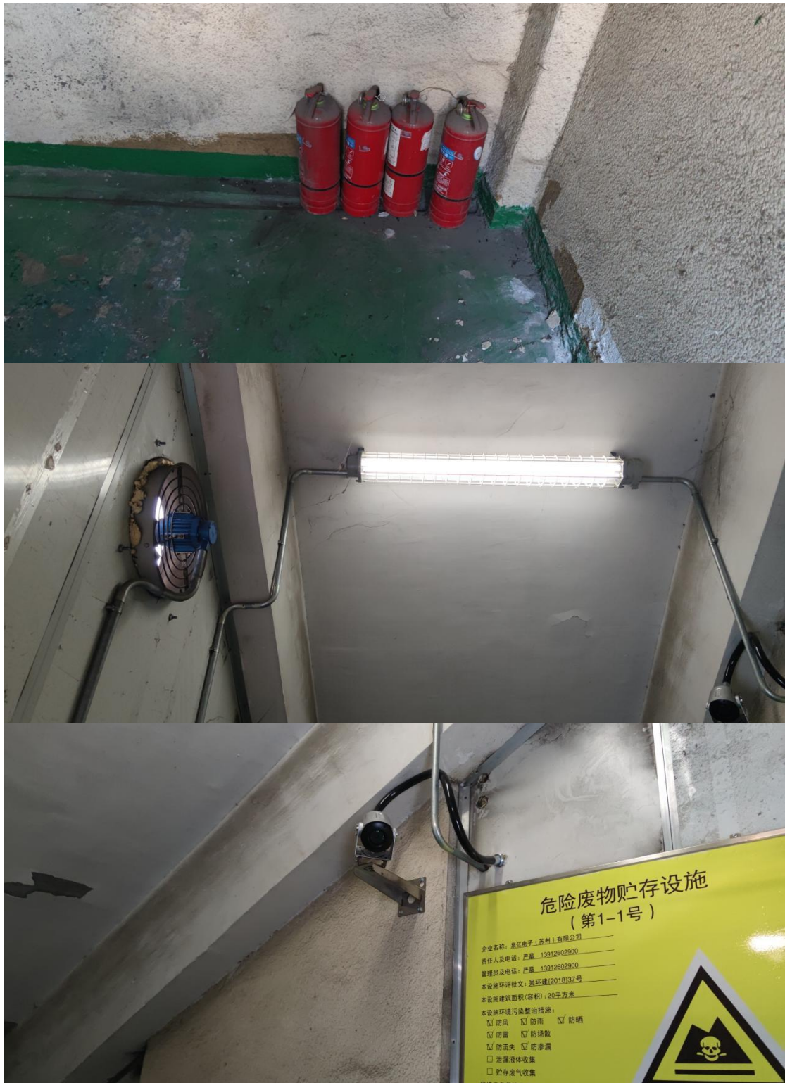
图4-1 本项目危废仓库
