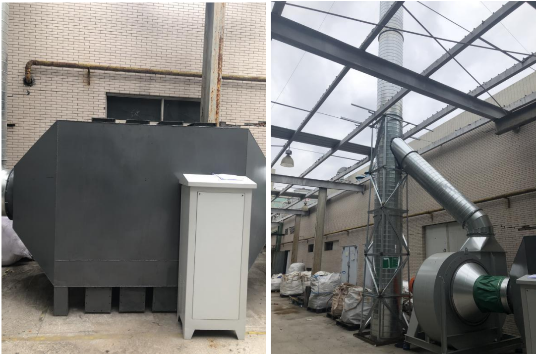
图 4-1 活性炭吸附装置及 DA001 排气筒照片
