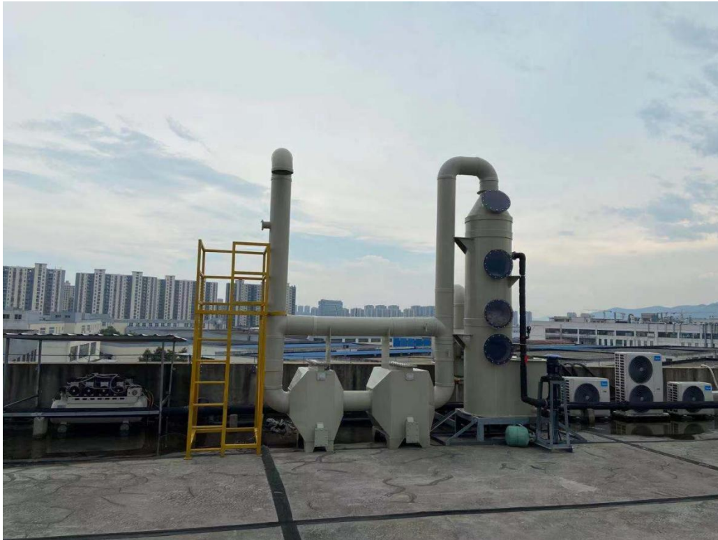
废气处理设施(水喷淋+二级活性炭)
