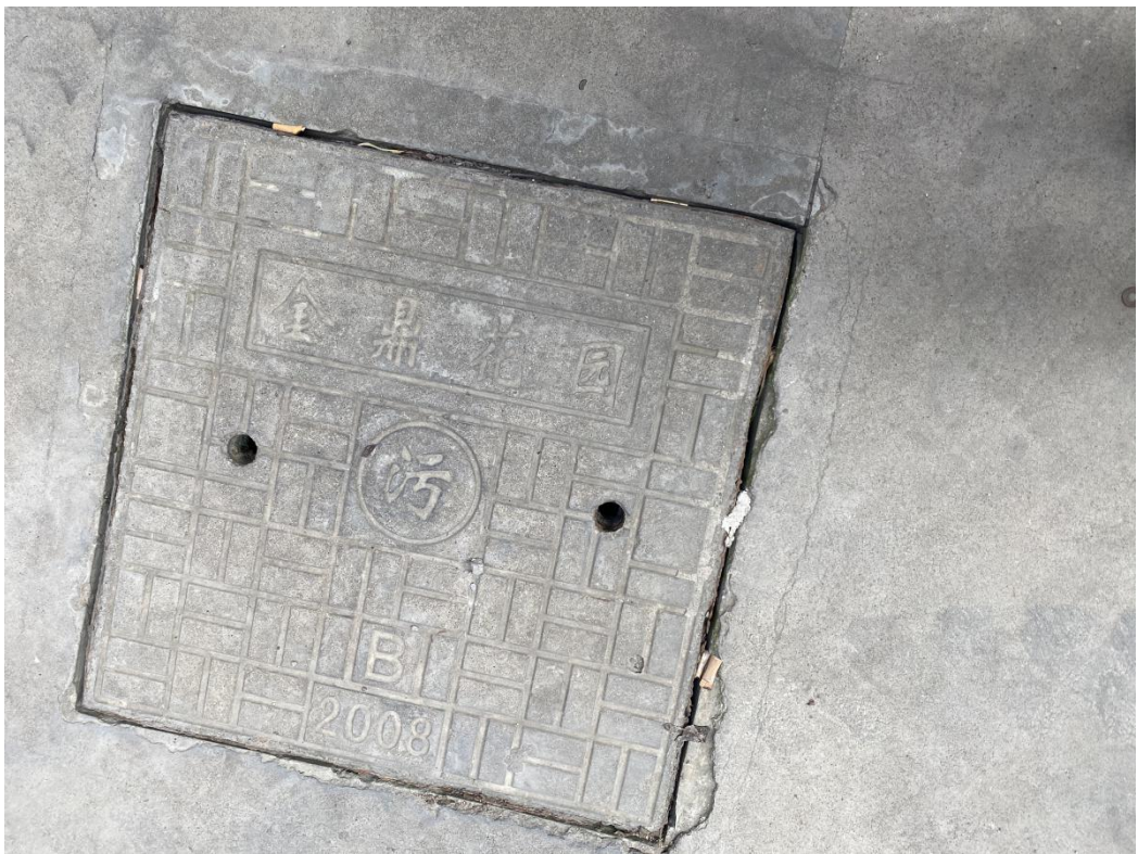
图 4-4 本项目污水排口
