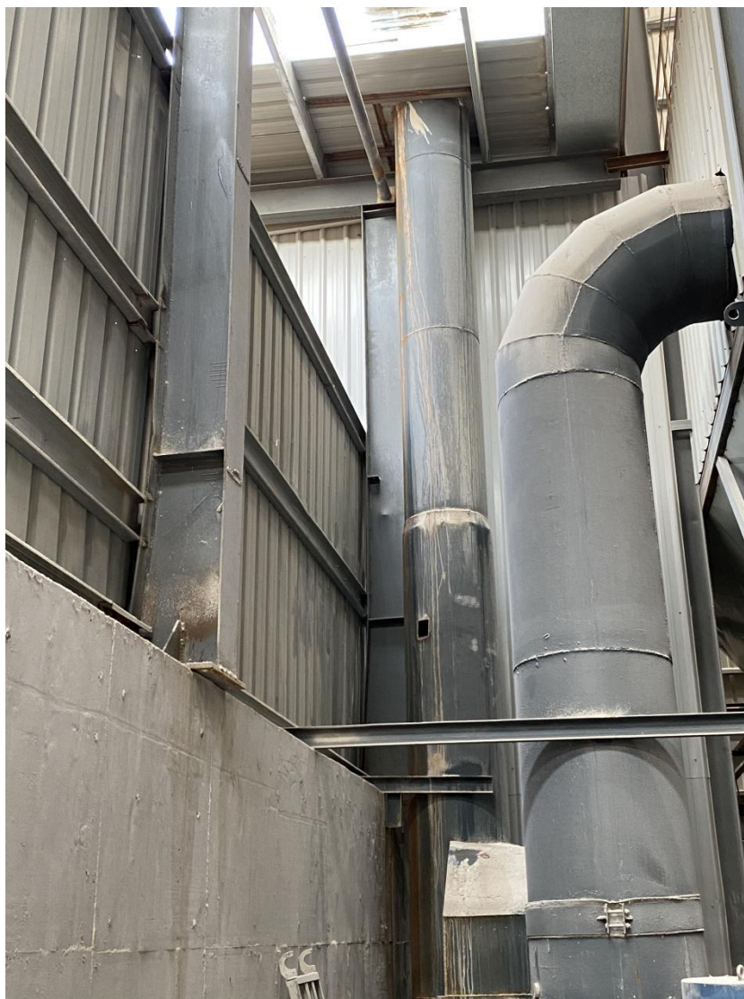
图 4-3 脉冲除尘设施及 DA003 排气筒
