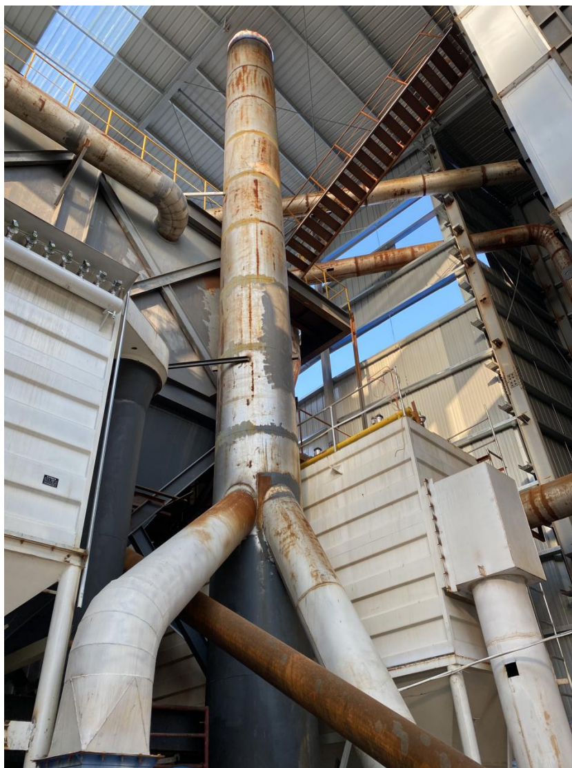
图4-34脉冲除尘设施及DA004排气筒
