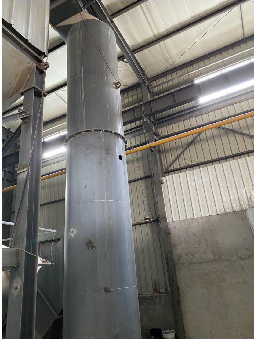
图 4-2 脉冲除尘设施及 DA002 排气筒
