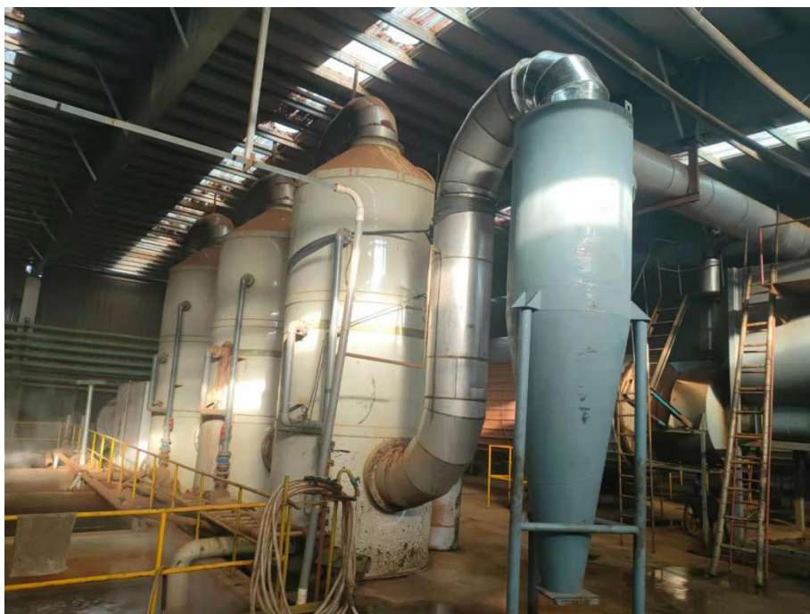
废气处理设施
