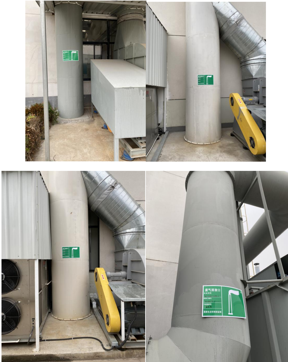
图 4-1 本项目排气筒
